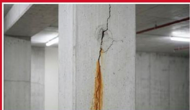
↑ Parkhaus Augsburg — Rissbreite 0,4 mm mit Rostfahne
