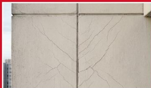
↑ Wohnhochhaus Regensburg — Diagonalarisse bis 0,25 mm
