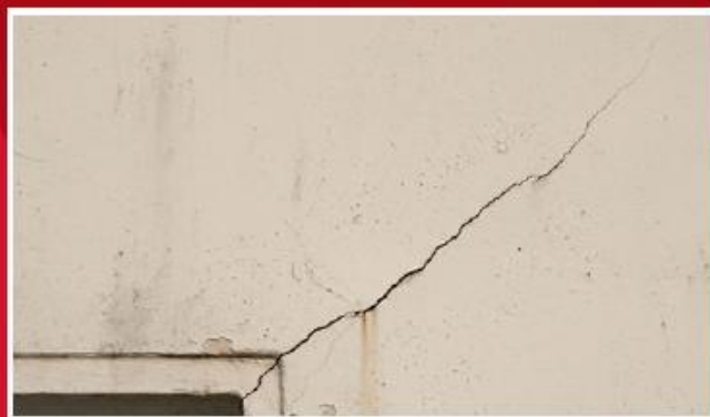
↑ Gewerbeobjekt Nürnberg — Rissbreite bis 0,45 mm
