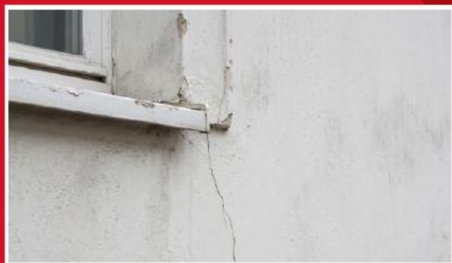
↑ Wohnanlage München — Rissbreite 0,1 mm
